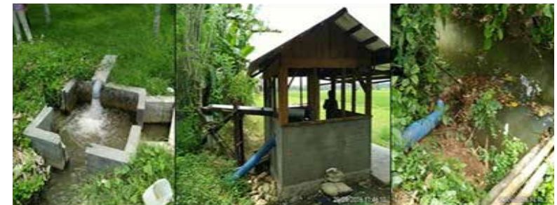
Gambar 36. Pemanfaatan air sungai dengan pompanisasi di Sungai Ciliuk, Desa Jaro, Kecamatan Jaro, Kabupaten Tabalong, Kalimantan Selatan
